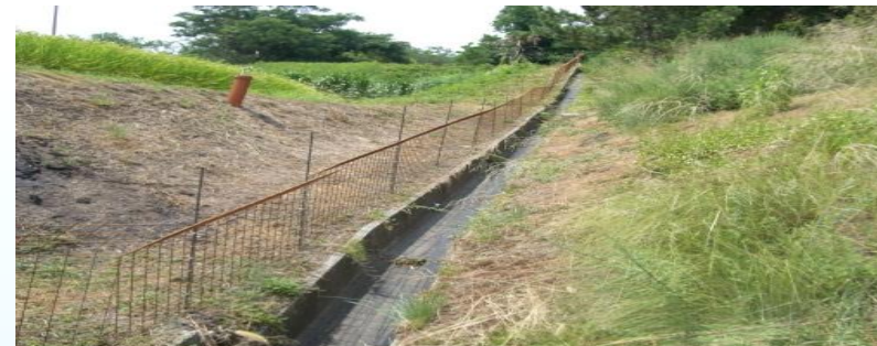
イノシシ侵入防止柵
