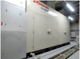
自家発電設備（1000kVA） 72時間運転が可能
