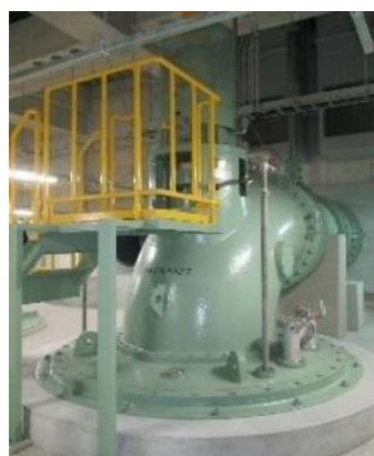
福岡ポンプ場 立軸ポンプ
