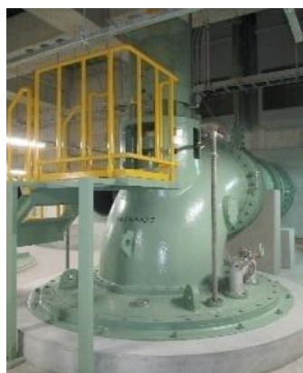
福岡ポンプ場 立軸ポンプ
