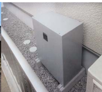
定置用蓄電システム
