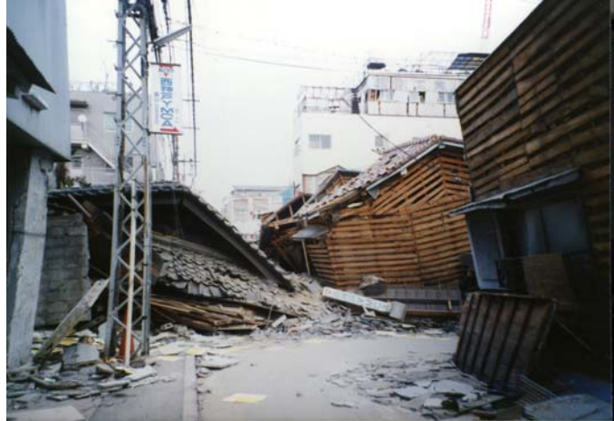
倒壊した木造住宅（阪神淡路大震災）
