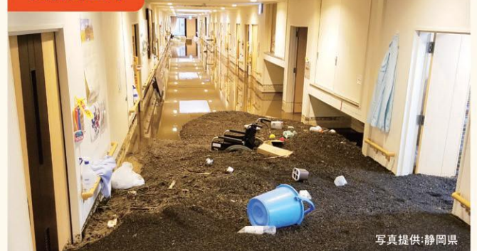
施設1階に土砂が大量に流入したが、全員無事
