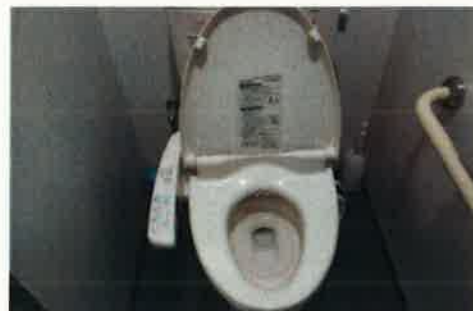
トイレの便器
