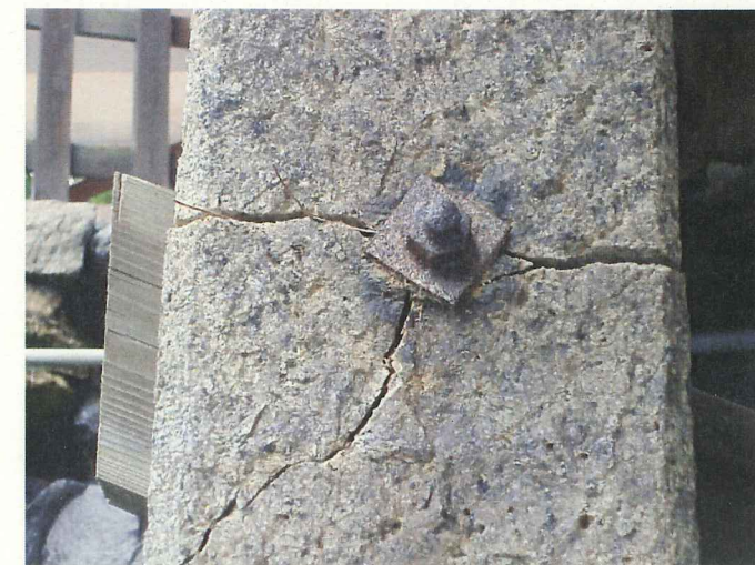
写真12 橋脚の破損状況
