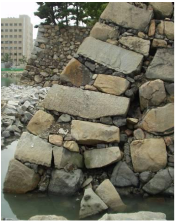
写真3 天守台石垣破損状況
