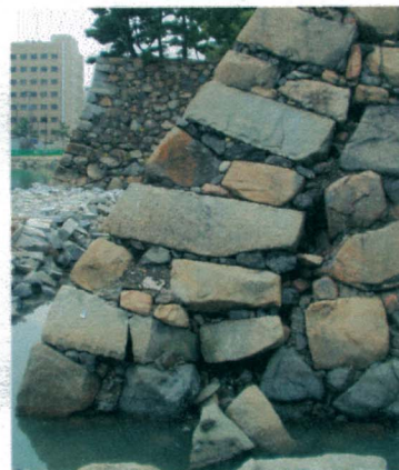
写真3 天守台石垣破損状況
