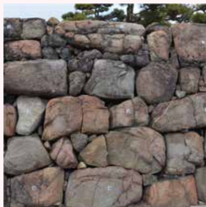
赤く変色した石材。ひびや割れも多い
