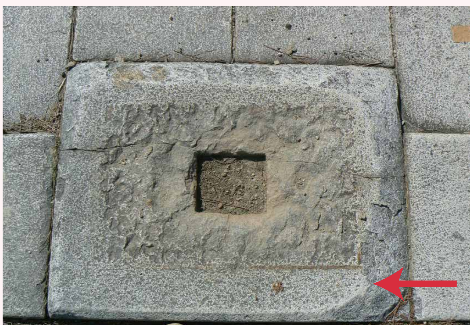
礎石に残る柱の痕跡（根巻金物の錆）
