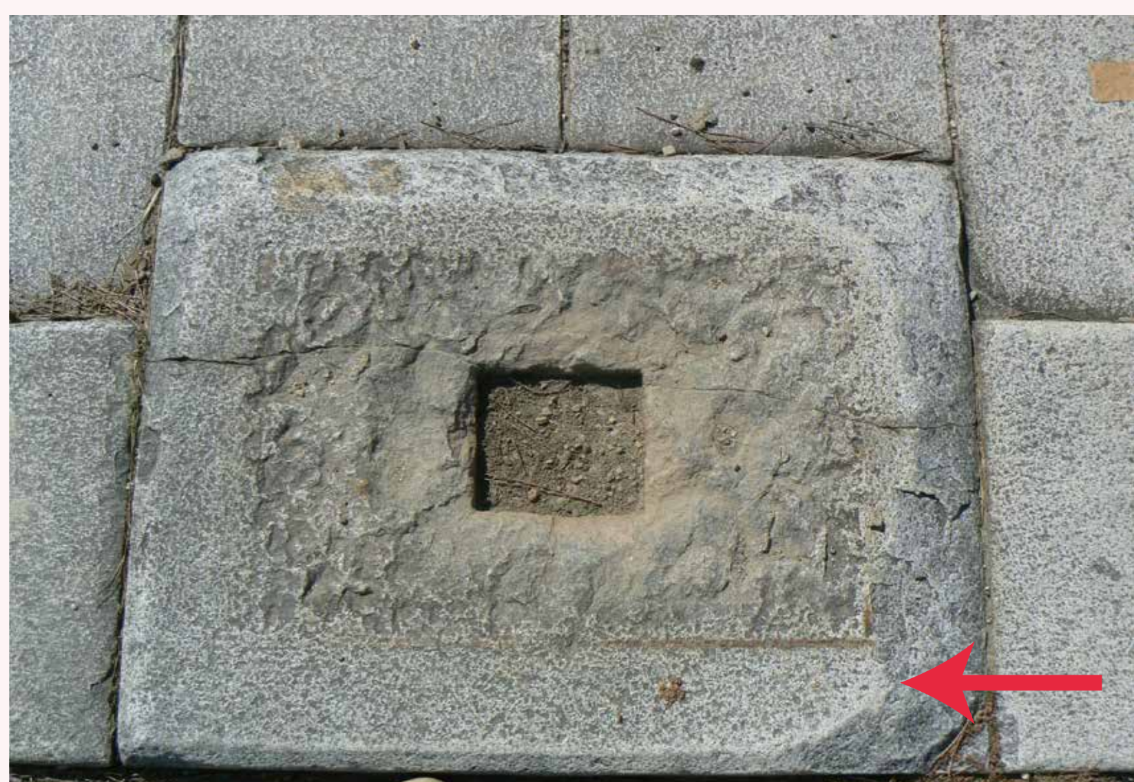
礎石に残る柱の痕跡（根巻金物の錆）
