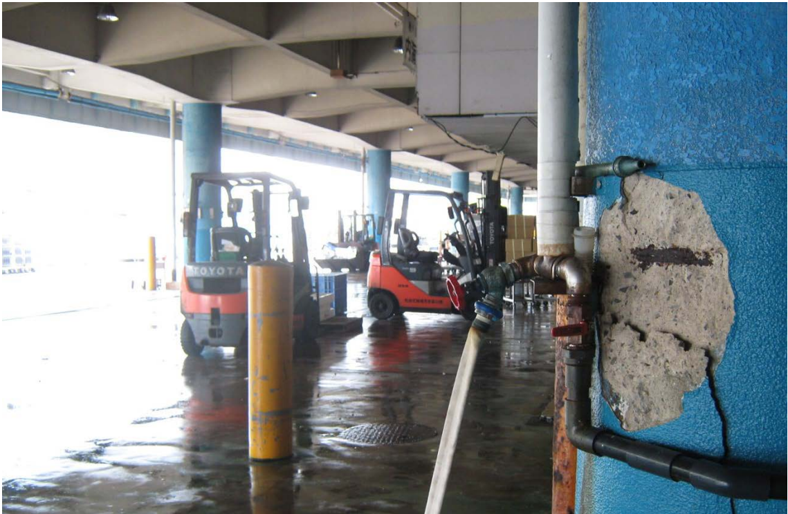
本市市場の劣化状況（平成27年）
