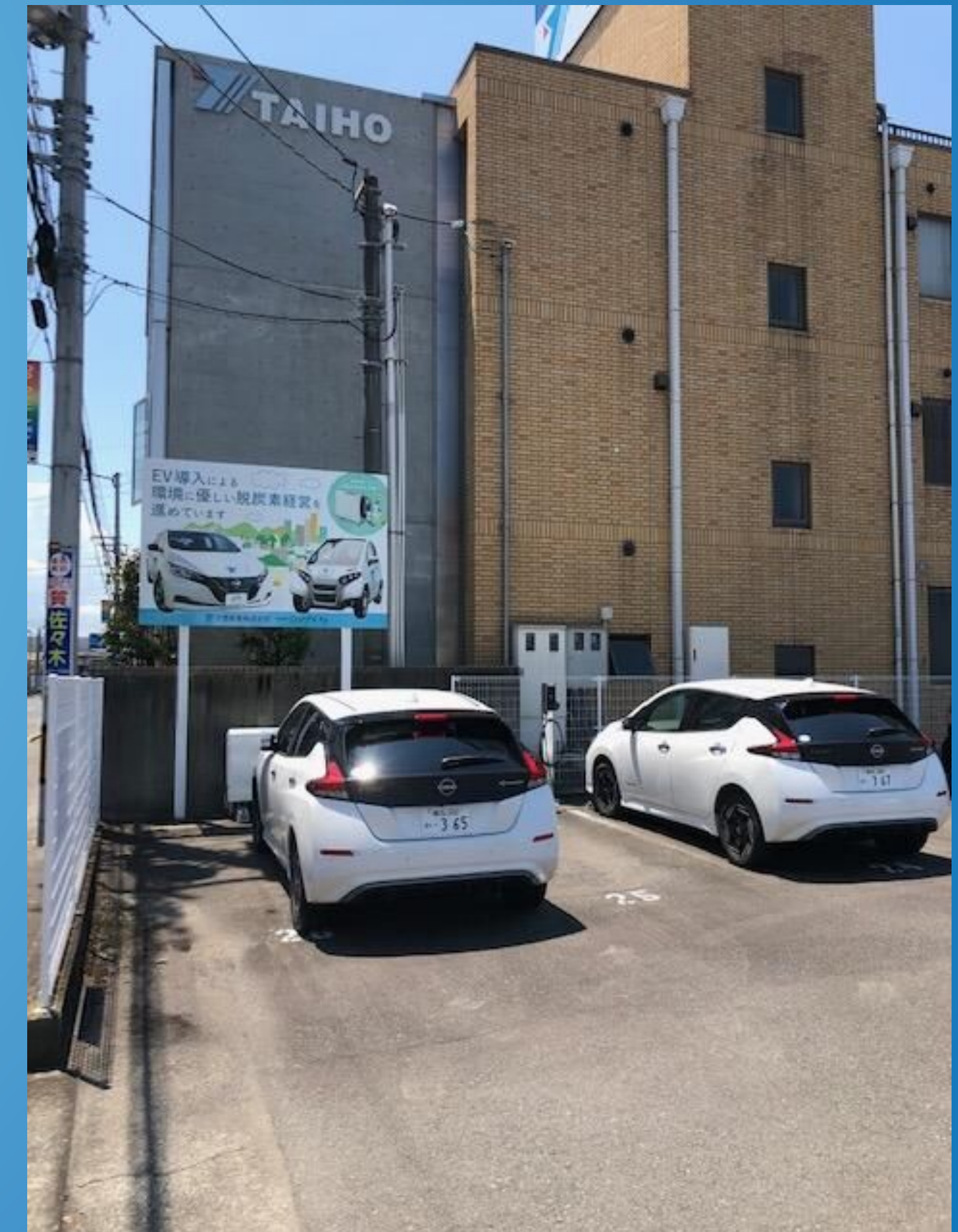
高松支店 設置状況
