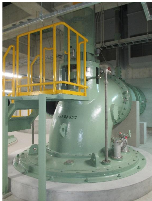
福岡ポンプ場 立軸ポンプ
