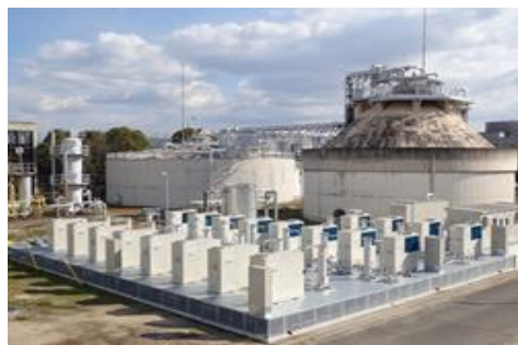
バイオマス発電設備
