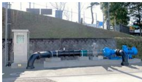
小水力発電設備
