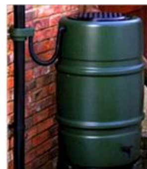
小規模貯留施設（雨水貯留施設）
