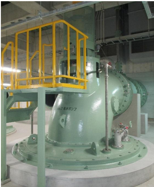
福岡ポンプ場 立軸ポンプ
