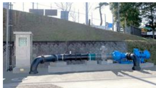
小水力発電設備
