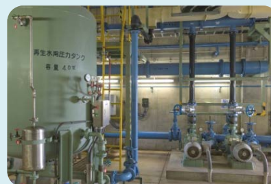
再生水処理施設
