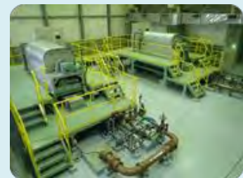
機械濃縮設備
