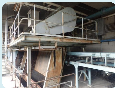
老朽化した下水処理施設
