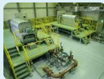
機械濃縮設備
