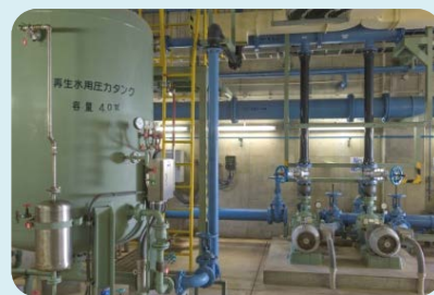
再生水処理施設
