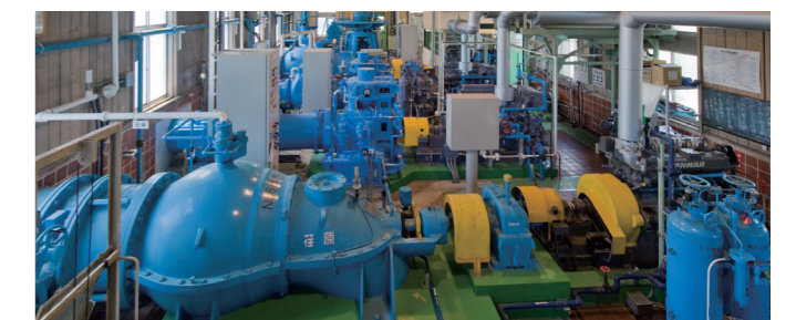
▲東部ポンプ場の横軸ポンプ
