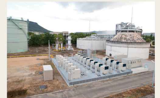
▲ バイオマス発電施設
