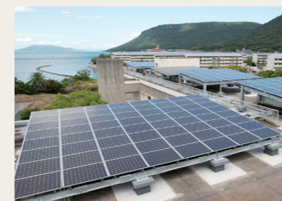
▲ 太陽光パネル
