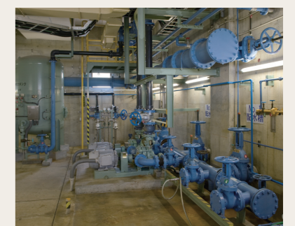
▲ 再生処理施設内部
