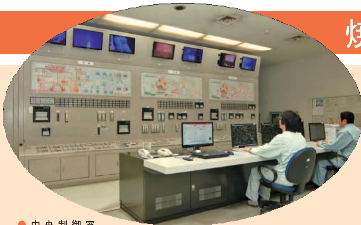
● 中央制御室 焼却炉の運転操作 公害防止機器の監視制御などを行います。
