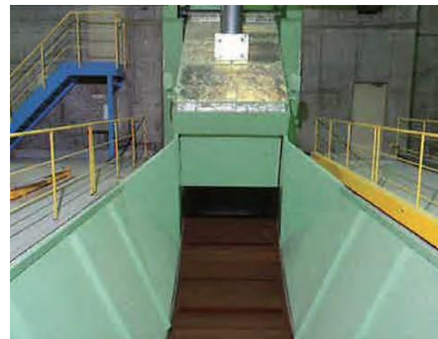
受入ホッパのごみは受入供給コンベヤで破碎機に送ります。
