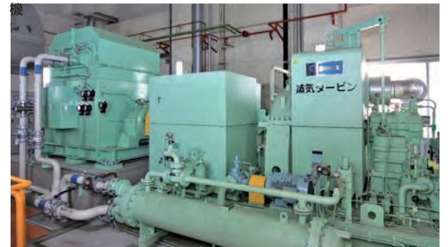
焼却熱で発生させた蒸気を利用した蒸気タービン発電機で発電し、施設で利用します。
