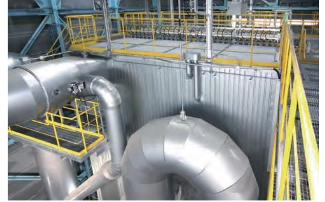
排ガスの中のばいじんはバグフィルタで微細なばいじんまで取り除きます。
