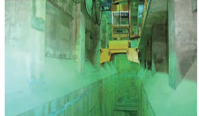
焼却灰は一旦ピットに貯留したのちに、灰クレーンでトラックに積み込み、最終処分場へ運ばれます。
