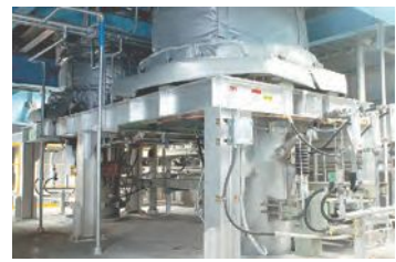
集じん機で集められた飛灰を加熱脱塩素化し、ダイオキシン類を分解します。
