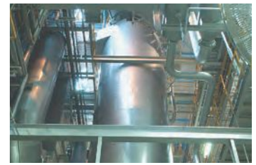
溶融炉から発生した排ガスを水噴射装置で所定の温度まで冷却します。
