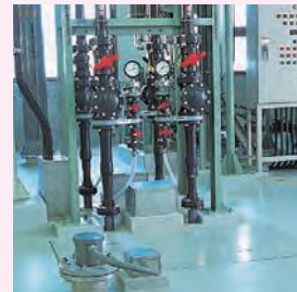
処理水槽(送水設備)
