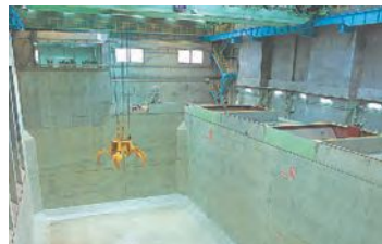
搬入されたごみをごみクレーンでごみホッパに投入します。
