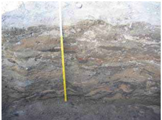
写真10 スベリ検出状況
