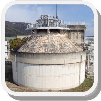
消化槽（発酵槽）
