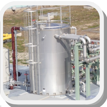
温水貯留タンク
