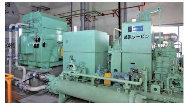
● 蒸気タービン発電機
