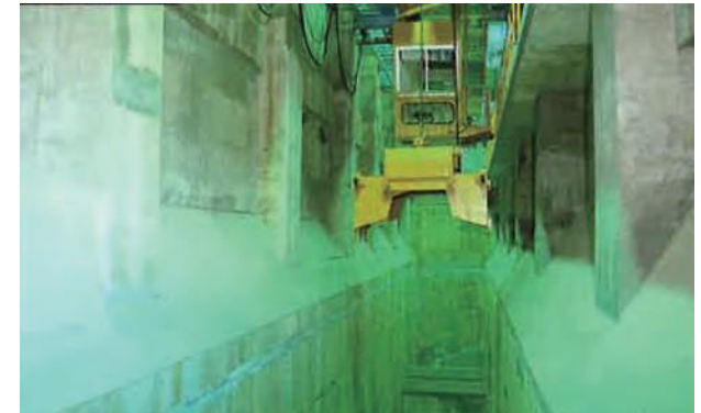
● 灰ピット・灰クレーン
