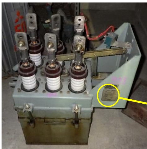
遮断器 (油入遮断器)
