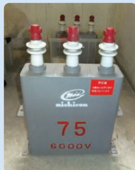
電力用コンデンサー
