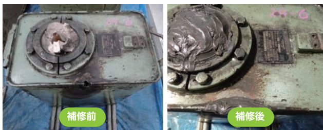
目止め材による補修例
