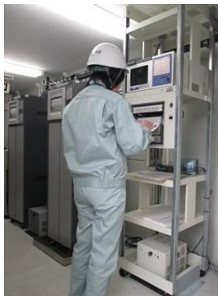
大気測定局での点検風景（東部運動公園測定局）
