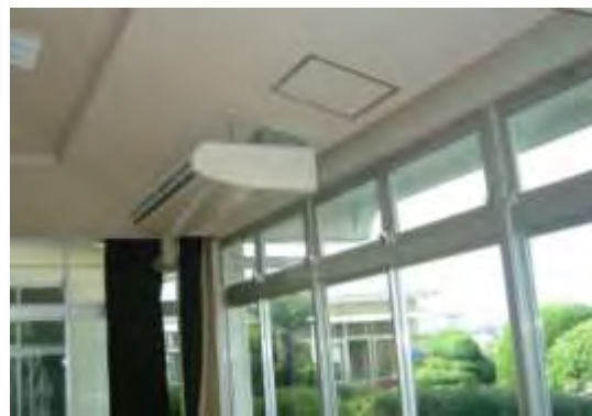
小・中学校へ整備する空調機
