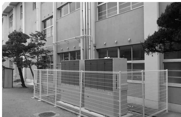
小・中学校へ整備した空調機
