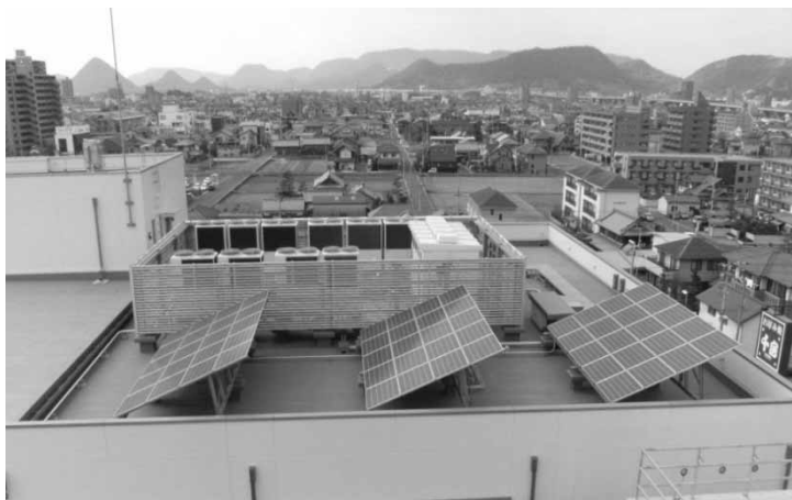
南消防署の太陽光パネル
