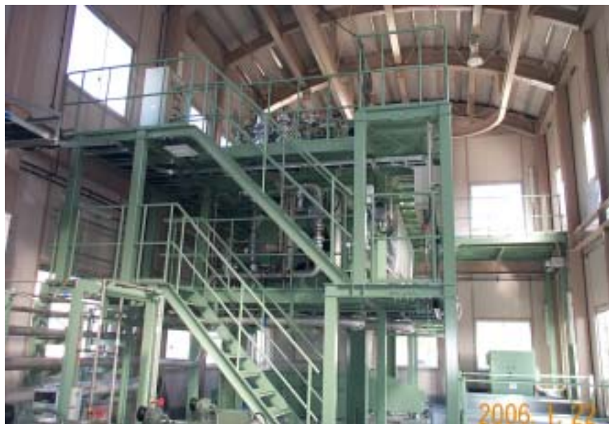
■川添浄水場排水処理施設
