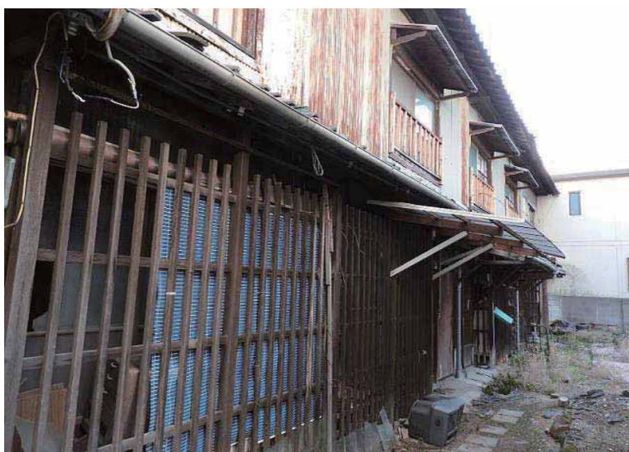
老朽危険空き家
