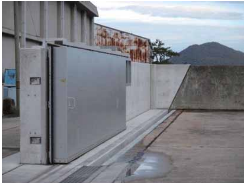
防潮壁及び防潮扉(高松漁港)
