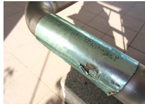
（手すりの点字が一部剥がれている。）
