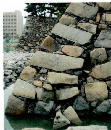
写真3 天守台石垣破損状況
