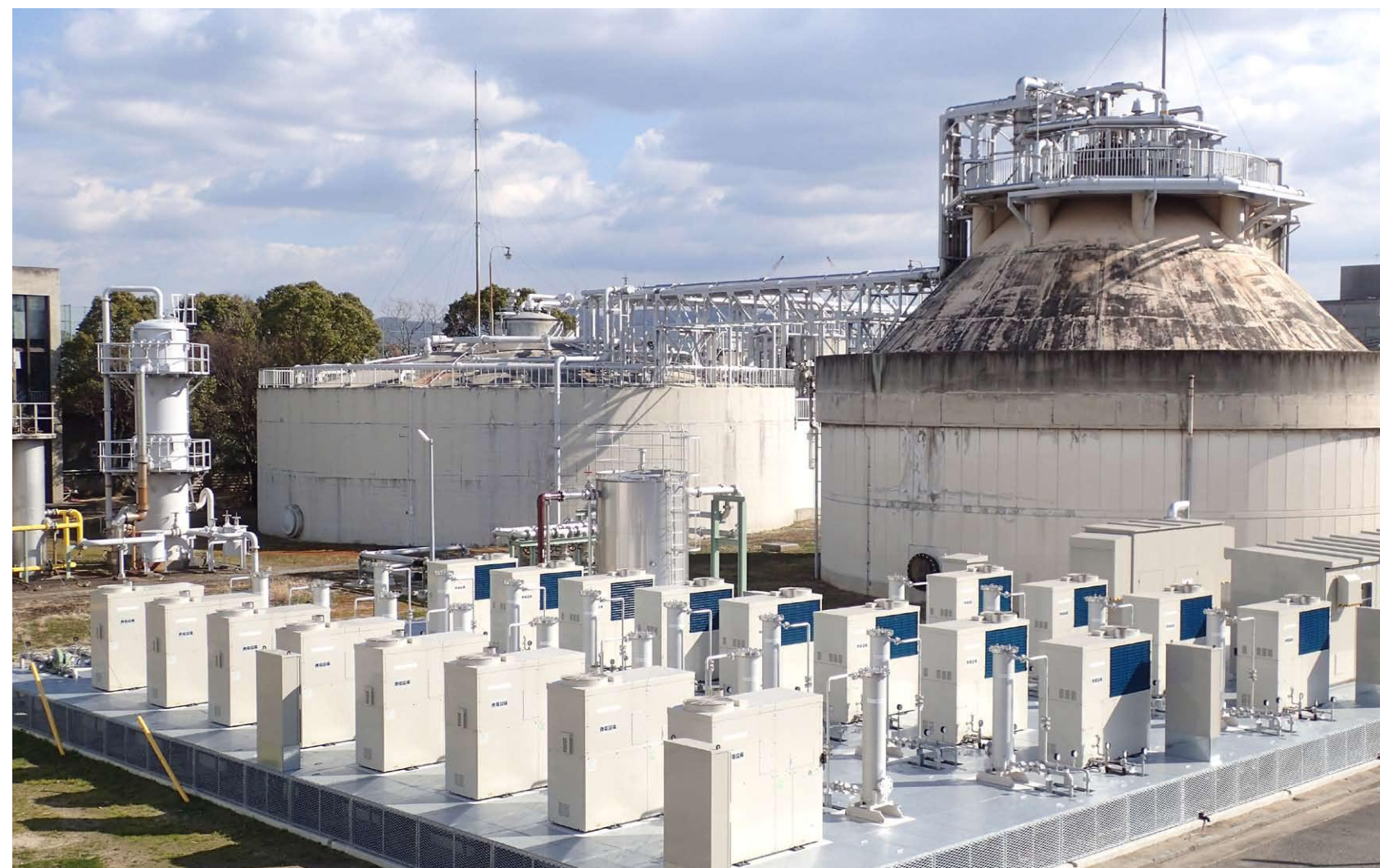
消化ガスを利用した発電設備[高松市東部下水処理場]
