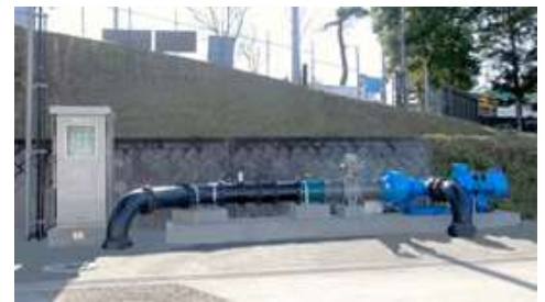
小水力発電設備
