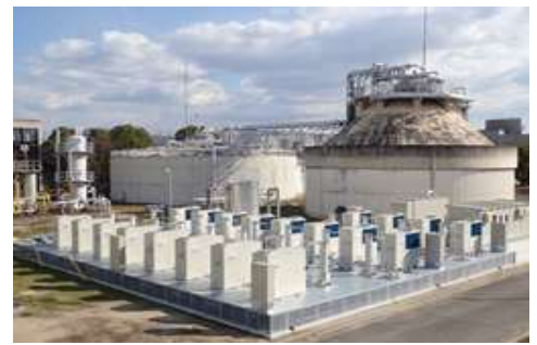
バイオマス発電設備
