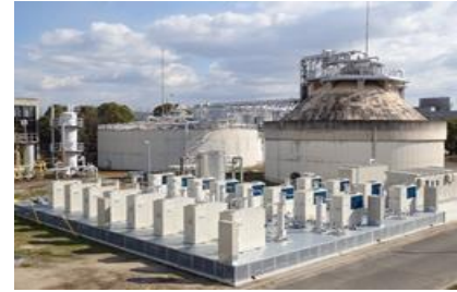
バイオマス発電設備
