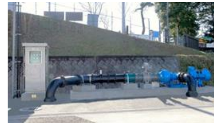
小水力発電設備
