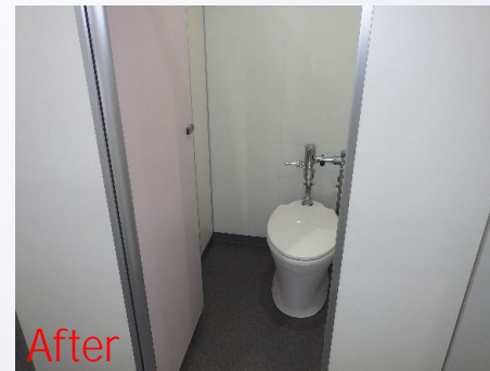
校舎棟 大便器
